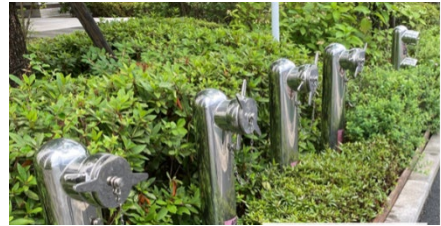
အဆောက်အအုံပြင်ပမီးသတ်ပစ္စည်းကိရိယာများ
